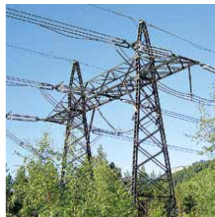
Et smartere kraftnett skal håndtere variasjonene i nettet, fra husholdningene til de store kraftprodusentene. Foto: Statnett
