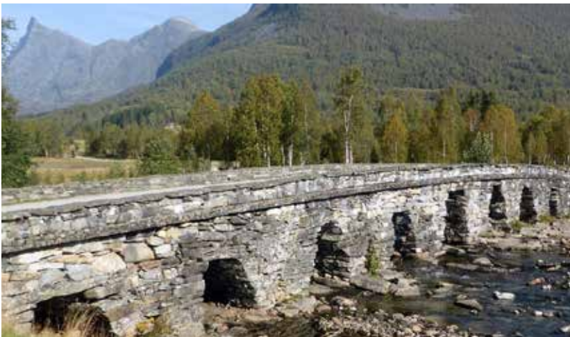
Horndøla bru, Volda kommune. Brua vart bygd mellom 1810 og 1813. Foto: Marit Anita Skrede, Statens vegvesen.
