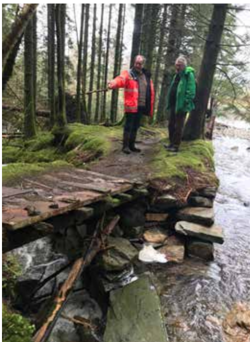
Flauskader på postvegen i Kistekleiva, Bergen. Ei demning brast på grunn av store nedbørsmengder 22. august 2018, og reiv med seg tørrmuren i denne kloppa. Foto: Tine Eikehaug, Statens vegvesen.
