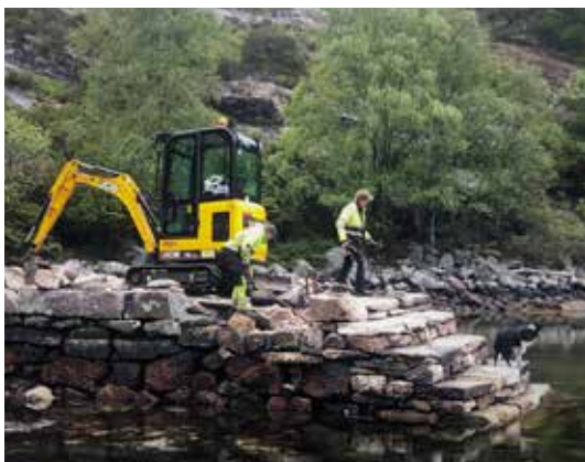
Restaurering av bryggja i Postvågen, Gulen, i 2019. Trappa i front av kaia og ein del av fyllmassane i toppen var vaska bort gjennom åra. Hellene vart henta opp frå sjøen og lagde på plass att. Foto: Marit Anita Skrede.
