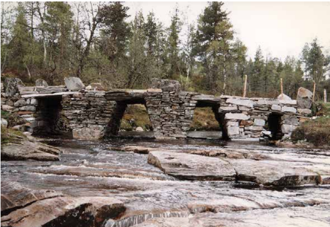
Ikkje særleg heldig restaurering. Her er det brukt både større stein med anna farge og form enn opphavleg mur har. Ny mur er også meir stabla enn mura og manglar bindingar. Foto: Statens vegvesen.
