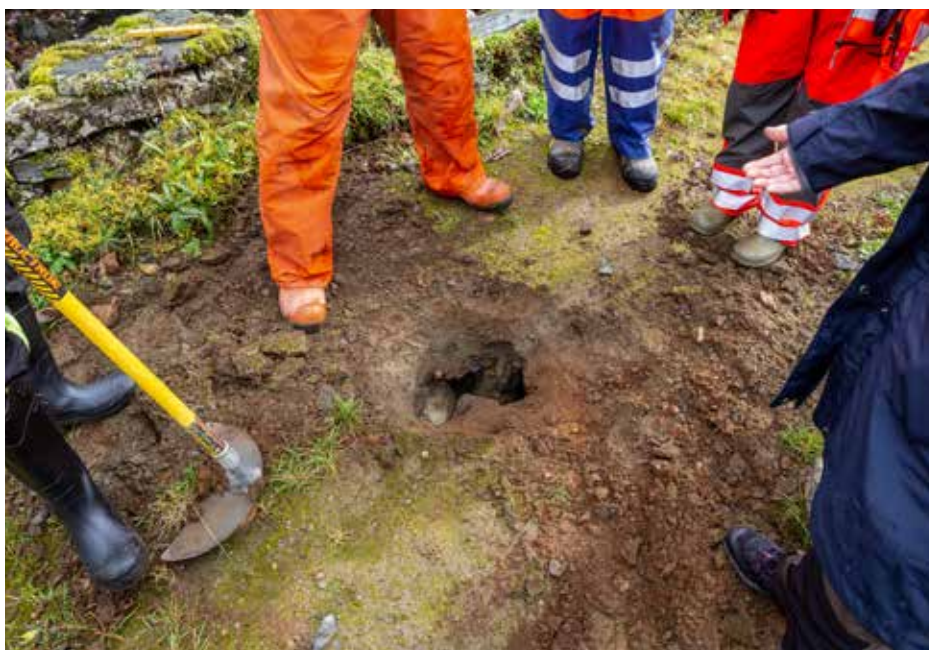
Høl i vegen på ei bru kan sjå uskyldig ut, men betyr ofte at det er setningsskadar i konstruksjonen. Foto: Silje Drevdal, Statens vegvesen.
