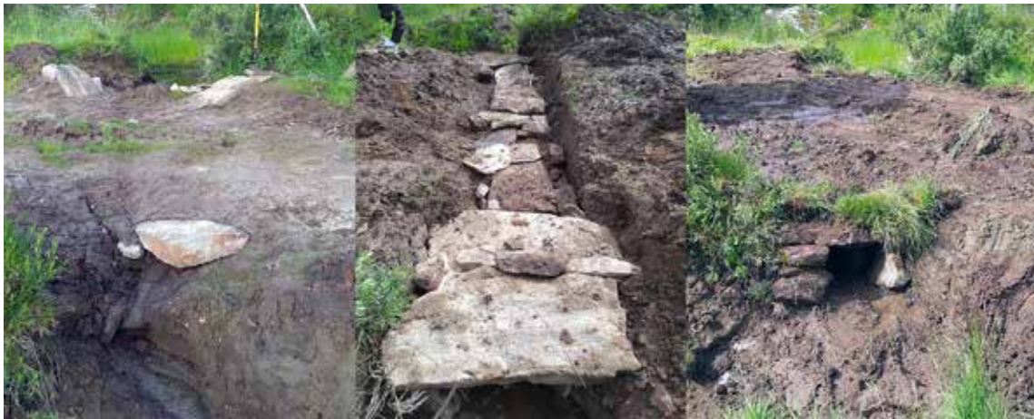
Ei heilt tett og usynleg stikkrenne (t.v.) som vart opna og steinane lagde på plass. Til slutt vart også same topplaget lagt tilbake. Foto: Sigmund Bødal, Statens vegvesen.
