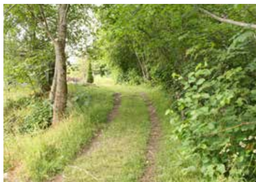
Døme på TG1. Vegen og grøftene er grodd att og treng vegetasjonsrydding! Foto: Siw Helen Myrvoll Grønland, Møre og Romsdal fylkeskommune.
