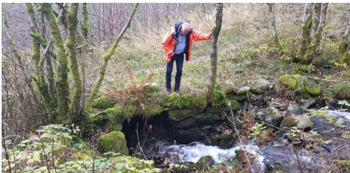
Årleg tilsyn med vegen, samt faste avtaler om vedlikehald og klipp av vegetasjon kan gjere mykje for ein gammal veg. Foto: Bjørn Eikje Ramberg, Statens vegvesen.
