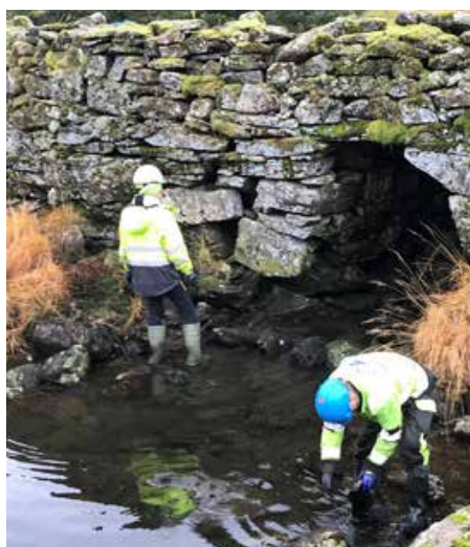
Døme på TG3: Stein nedst i steinkaret har rasa ut og konstruksjonen står i fare for å kollapse. Foto: Tine Eikehaug, Statens vegvesen.
