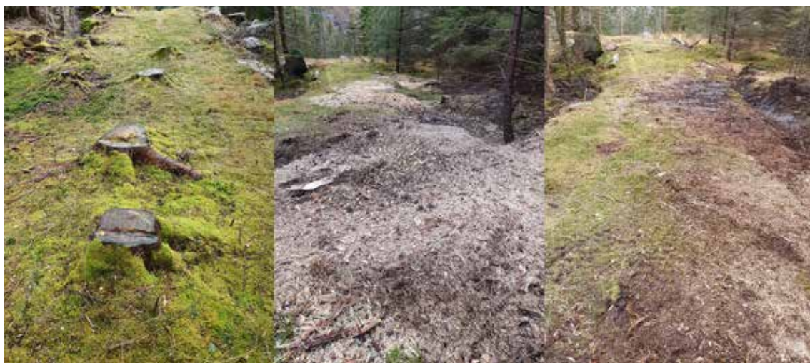
Fresing av stubbar i postvegen. I midten er stubbane freste heilt ned, til høgre er flisa raka bort. Denne vert lagt i haugar utanfor vegen og dekkta til med mold. Til jobben er det brukt ein lett gravemaskin på 1.9 tonn med belte og med stubbefres på. Foto: Jarle Halsvik.
