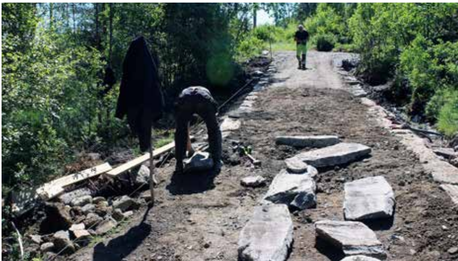
Gjenskaping av kantmur langs ei strekning der muren var graven bort. Foto: Tine Eikehaug, Statens vegvesen.
