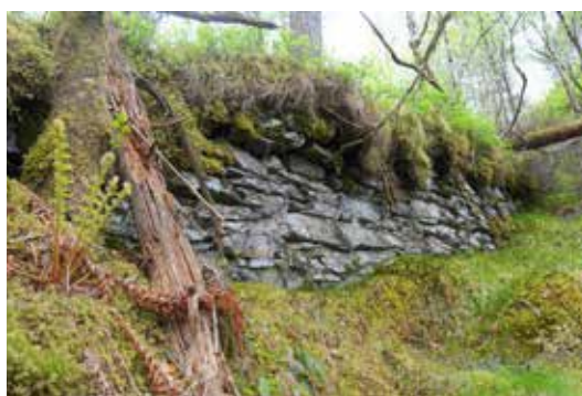
Døme på TG2: Setningsskadar i øvste del av mur og delar av muren er på veg til å rase. Skaden må haldast under oppsyn. Foto: Sigrun Wølstad, Hordaland fylkeskommune.
