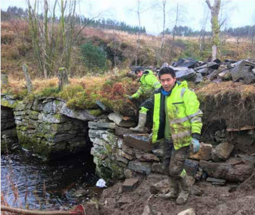
Restaurering av eit landkar på Gaulen bru i Lindås vart utført utan bruk av maskiner. Brua er frå 1790-åra og elles i god stand. Foto: Tine Eikehaug, Statens vegvesen.
