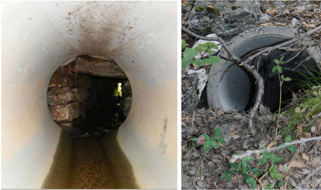
Figur 28. Uohensiktsmessige reparasjoner, slik som påskjøttet stikkrenne til venstre, og manglende driftsrutiner kan øke utfordringer for drenering i et våtere klima. Foto: Kristine Flesjø
