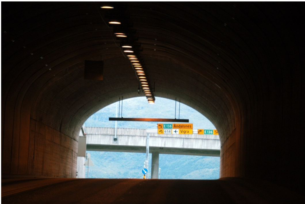
Figur 32. Stigende havnivå og endring i bølgemønster kan være en utfordring for noen tunnelportaler mht overskylling. Foto: Ålesundtunnelene, Knut Opeide
