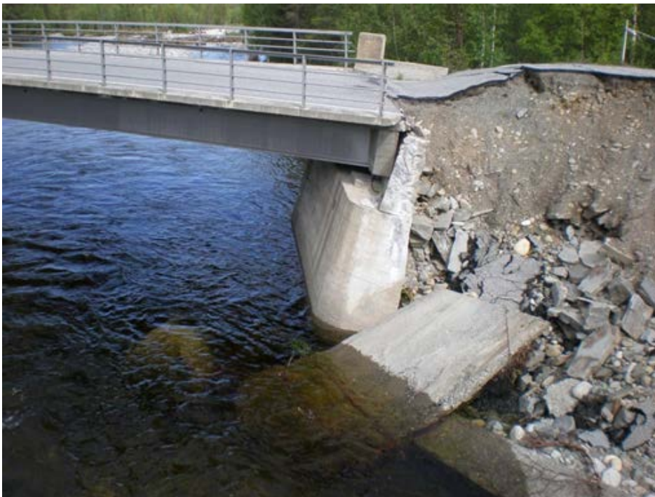
Figur 25. Káraáshjohka bru med erosjonsskader på brufundament, mai 2010. Foto: Statens vegvesen Region nord
