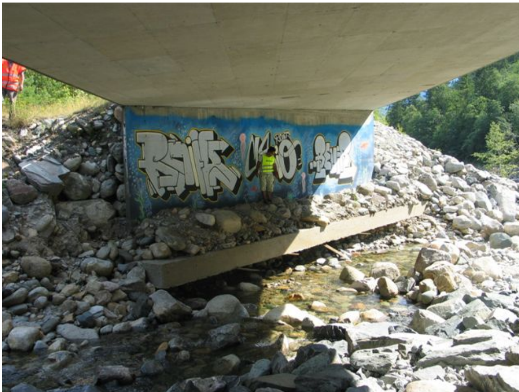
Figur 30. Middøla bru (08-1489) i Tinn kommune, riksvei 37, ca. 8 km øst for Rjukan, ble bygget i 1990. Fundamentene har blitt undergravd flere ganger, senest i 2008. Se prosjektrapport TEK 2560
