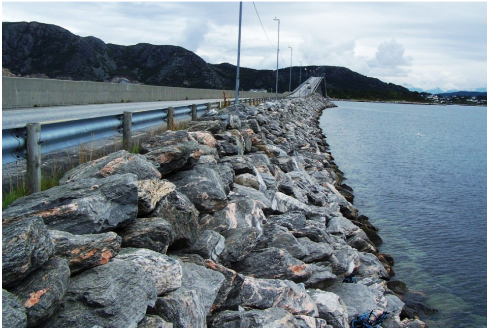
Figur 33. Giskefyllinga (fv. 658) har vært tema for casestudie pga bølgeoverskylling og erosjon
