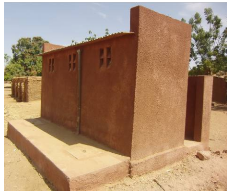
Latrines construites à Yékétééré
