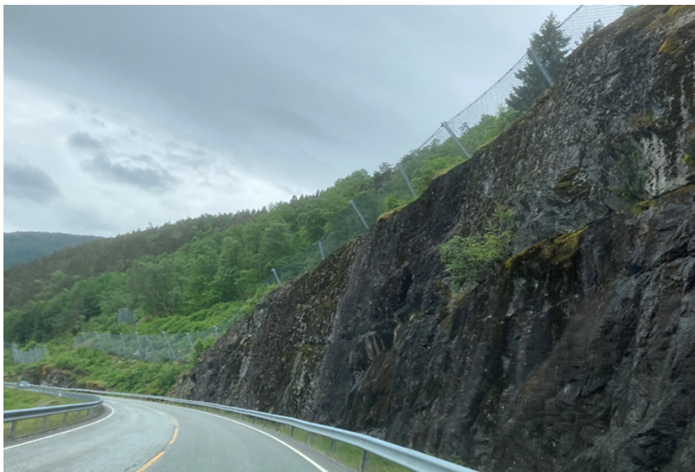
Figur 9-2 Eksempel på nylig oppsatt fanggjerd, Luster i Sogn.
