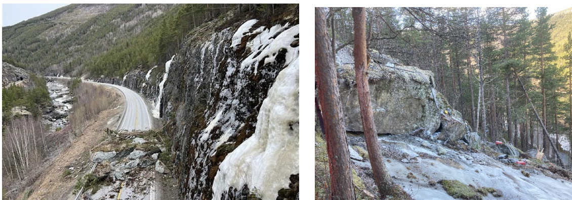
Figur 1-2 Bilder av skredområdet ved Rosten. Venstre: Oversiktsbilde tatt av Statens vegvesen (SVV 2025b). Høyre: Bilde tatt av ekspertutvalget i forbindelse med befaring 7. april 2025 av utløsningsområdet og gjenstående blokker med usikker stabilitet.
