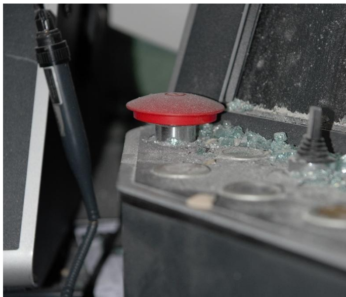
Figur 8: Nødstopppknapp med støvlag. Foto: SHK
