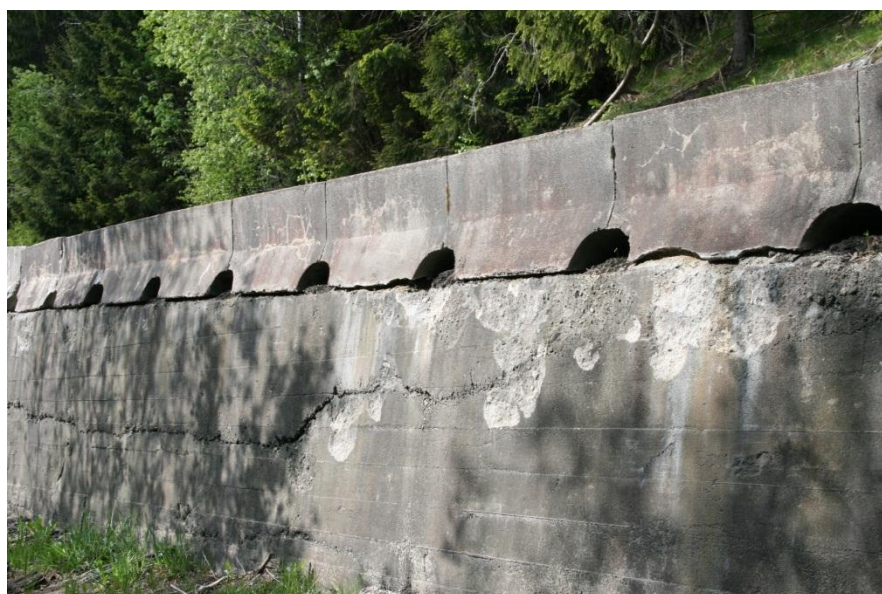
FIGUR 12 EKSEMPEL PÅ SKADET MUR (FOTO: STATENS VEGVESEN)
