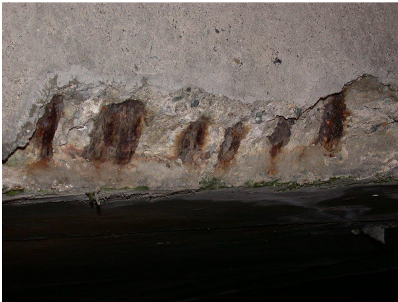
FIGUR 2 EKSEMPEL PÅ KORRODERT ARMERING PÅ BETONGBRU (FOTO: JAN MAGNUS ØSTVIK, STATENS VEGVESEN)
