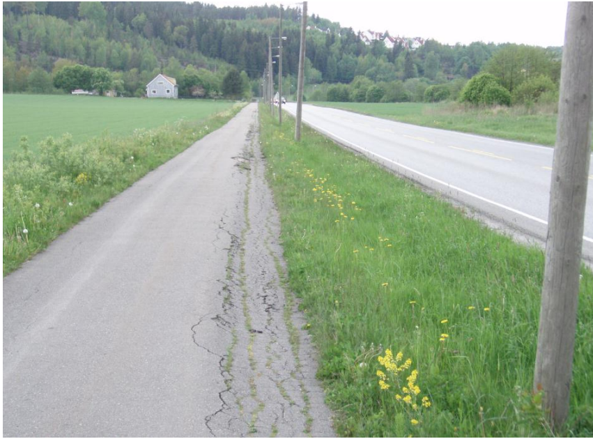
FIGUR 10 EKSEMPEL PÅ SKADET VEGDEKKE PÅ GANG-/SYKKELVEG (FOTO: STATENS VEGVESEN)
