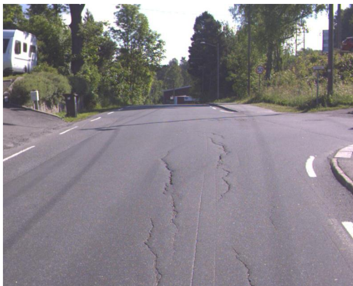
FIGUR 38 OPPSPRUKKET VEGDEKKE PÅ FV 8 I RISØR (FOTO: STATENS VEGVESEN)
