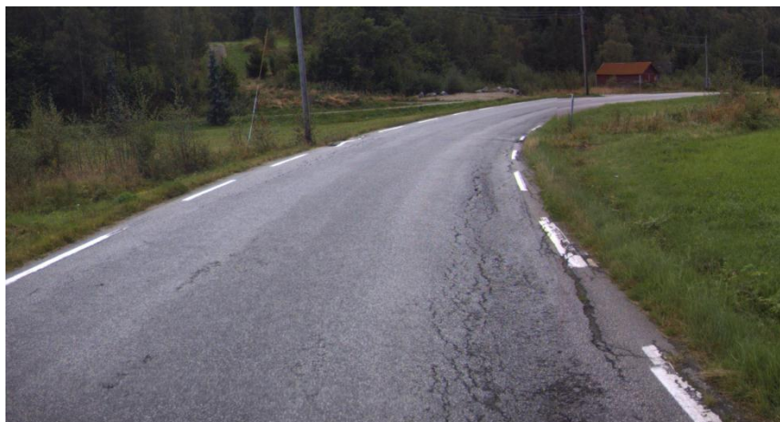
FIGUR 41 SKADET VEGDEKKE PÅ FV 43 I HÆGEBOSTD KOMMUNE (FOTO: STATENS VEGVESEN)
