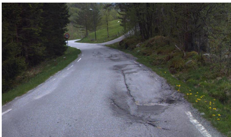
FIGUR 47 ALVORLIGE DEKKESKADER PÅ DEN LAVTRAFIKKERTE FV 713 I SAUDA KOMMUNE (FOTO: STATENS VEGVESEN)
