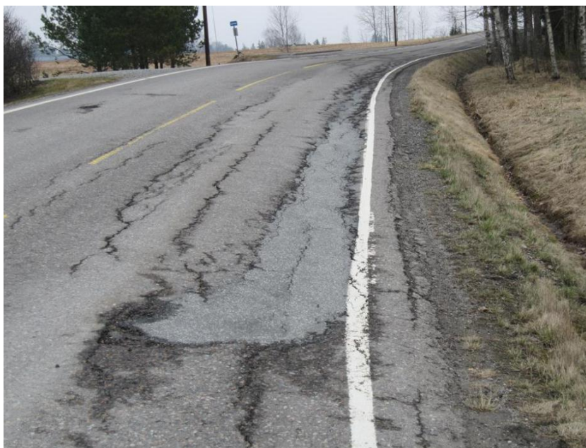
FIGUR 7 EKSEMPEL PÅ SVAKT VEGFUNDAMENT OG DEKKESKADER (FOTO: STATENS VEGVESEN)
