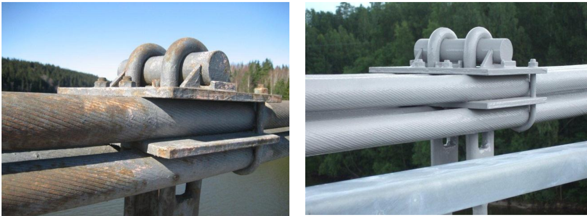
FIGUR 3 EKSEMPEL PÅ KORRODERT OVERFLATE PÅ HENGEBRUKABLER FØR OG ETTER TILTAK , VAMMA BRU PÅ FV 115 I ØSTFOLD - (FOTO: STATENS VEGVESEN)
