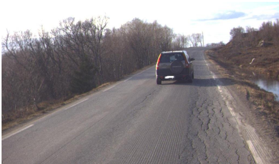
FIGUR 79 VEGDEKKE MED SVAKT VEGFUNDAMENT, DÅRLIG DRENERING OG OMFATTENDE DEKKESKADER (FOTO: STATENS VEGVESEN)
