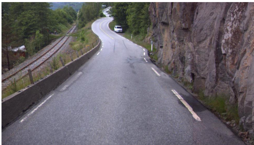
FIGUR 42 SMAL VEG MED MANGELFULL DRENERING PÅ FV 953 I FLEKKEFJORD KOMMUNE (FOTO: STATENS VEGVESEN)
