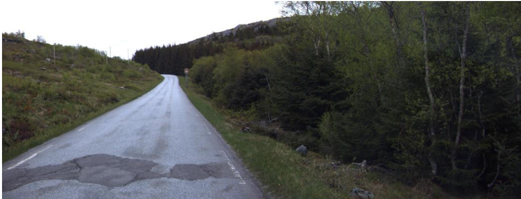
FIGUR 80 SKADET VEGDEKKE PÅ FV17 (FOTO: STATENS VEGVESEN)
