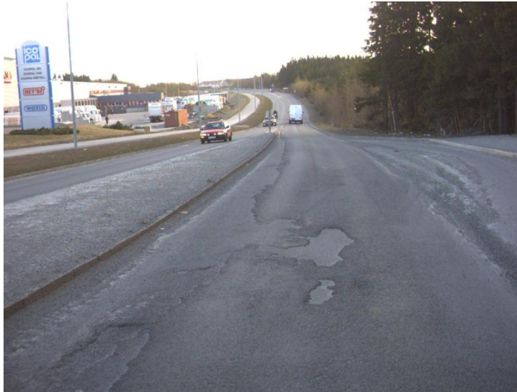
FIGUR 62 SKADET VEGDEKKE PÅ FV 902 I TRONDHEIM KOMMUNE (FOTO: STATENS VEGVESEN)
