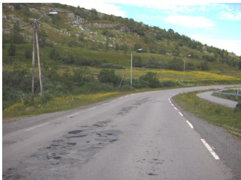
FIGUR 86 DEKKESKADER PÅ FV 891 NÆR BÅTSFJORD (FOTO: STATENS VEGVESEN)
