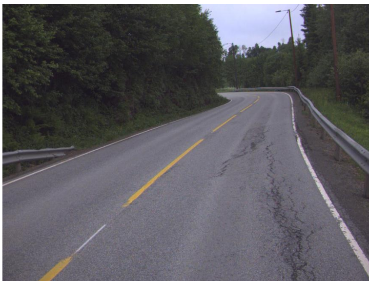
FIGUR 64 SKADET VEGDEKKE PÅ FV 705 I SELBU KOMMUNE (FOTO: STATENS VEGVESEN)
