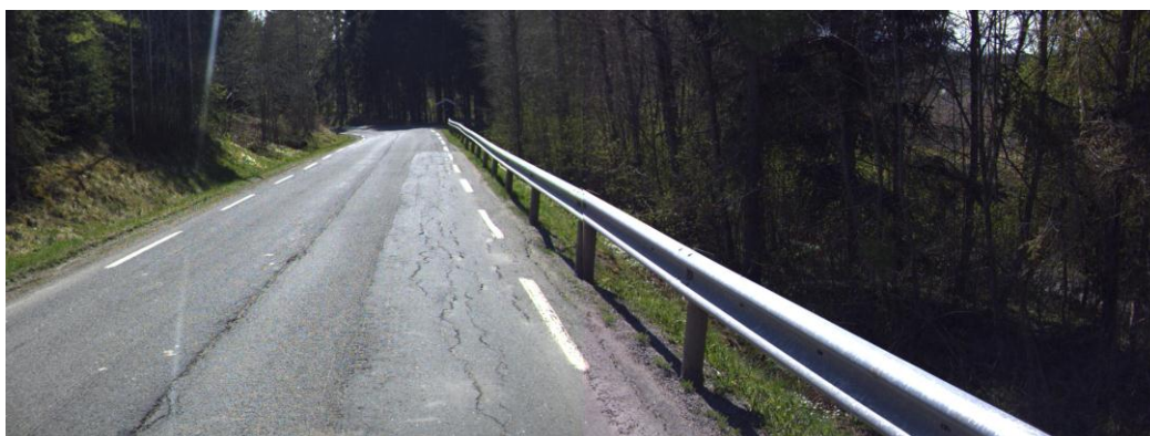
FIGUR 24 DÅRLIG DEKKETILSTNAD PÅ LAVTRAFFIKERT FYLKESVEG I ENEBAKK KOMMUNE (FV 326) (FOTO: STATENS VEGVESEN)
