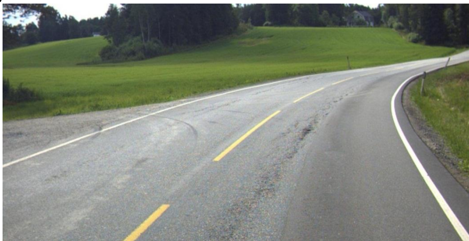
FIGUR 21 SKADET VEGDEKKE PÅ FV 22 I RAKKESTAD KOMMUNE (FOTO: STATENS VEGVESEN)
