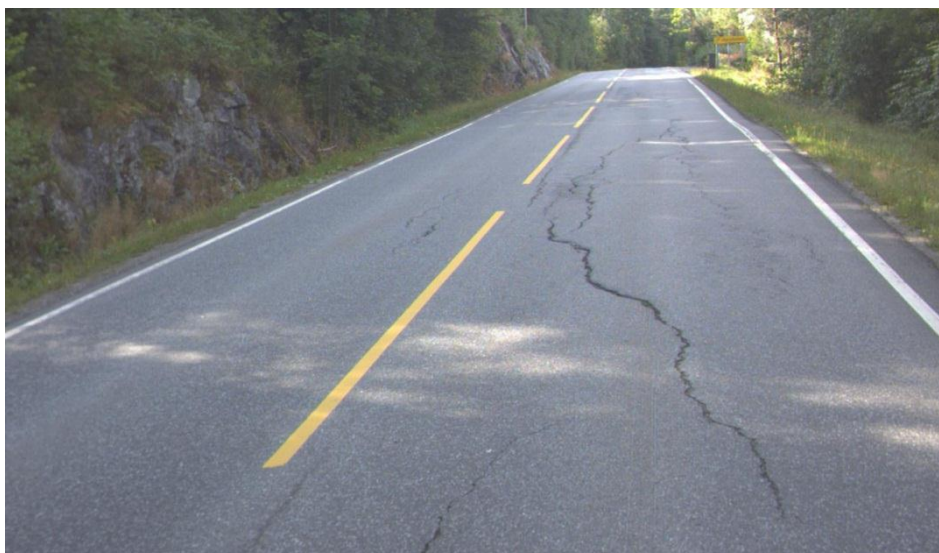
FIGUR 35 OPPSPRUKKET VEGDEKKE PÅ FV 356 (FOTO: STATENS VEGVESEN)
