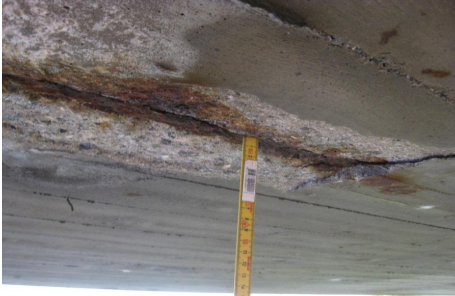
FIGUR 66 KORRODERT ARMERING PÅ MAUSUND BRU PÅ FV 436 (FOTO: STATENS VEGVESEN)
