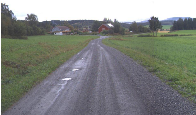
FIGUR 69 GRUSDEKKE MED SLAGHULL PÅ FV 132 I LEVANGER KOMMUNE (FOTO: STATENS VEGVESEN)
