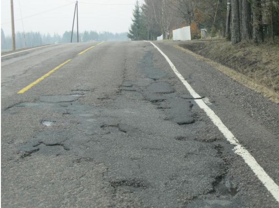
FIGUR 8 SKADET VEGDEKKE SOM HAR BLITT FORSØKT REPARERT MED LAPPING (FOTO: STATENS VEGVESEN)
