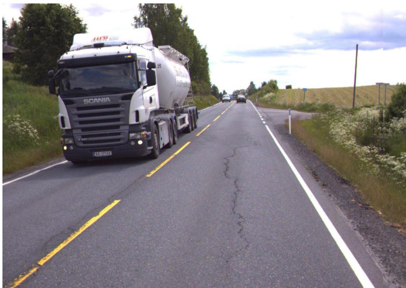
FIGUR 30 VEGDEKKE LAGT I 2008 BEGYNNER Å SPREKKE OPP PÅ FV 280 I MODUM KOMMUNE (FOTO: STATENS VEGVESEN)
