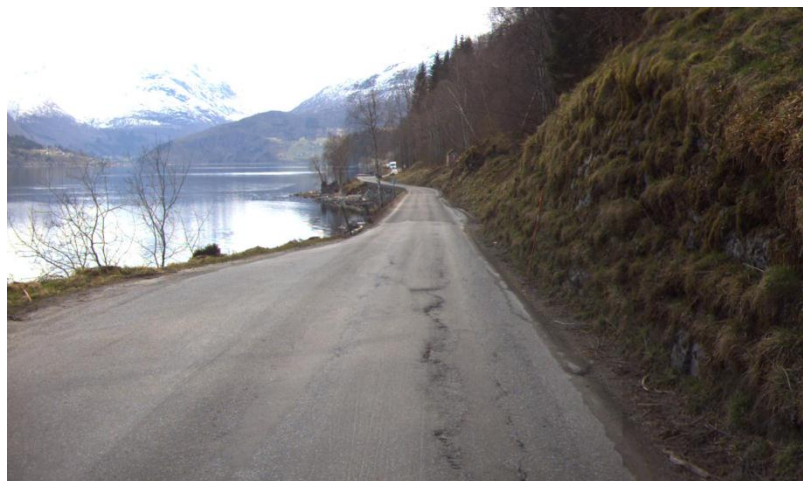
FIGUR 55 SMAL VEG MED DÅRLIG DRENERING OG SKADET DEKKE PÅ FV 60 I STRYN KOMMUNE (FOTO: STATENS VEGVESEN)
