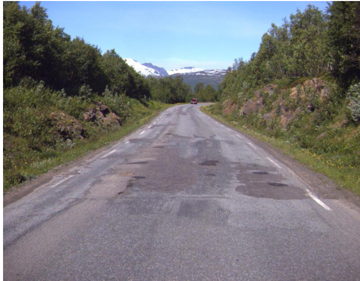
FIGUR 81 SKADET VEGDEKKE PÅ FV 86 PÅ SENJA (FOTO: STATENS VEGVESEN)
