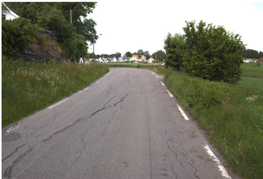
FIGUR 32 MANGELFULL DRENERING OG SKADET VEGDEKKE PÅ FV 51 I LARVIK KOMMUNE (FOTO: STATENS VEGVESEN)
