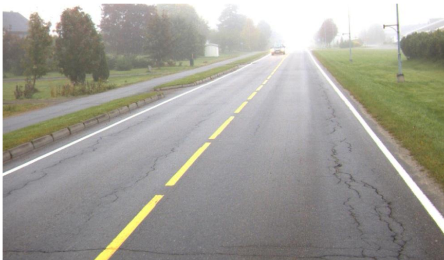
FIGUR 25 SKADET VEGDEKKE PÅ FV 508 I VÅLER KOMMUNE (FOTO: STATENS VEGVESEN)
