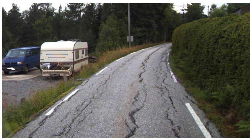
FIGUR 52 VEGDEKKE SOM ER GÅTT FULLSTENDIG I OPPLØSNING PÅ DEN LAVTRAFIKKERT FV 391 I LINDÅS KOMMUNE – HER VIL IKKE REASFALTERING ALENE LØSE PROBLEMENE (FOTO: STATENS VEGVESEN)
