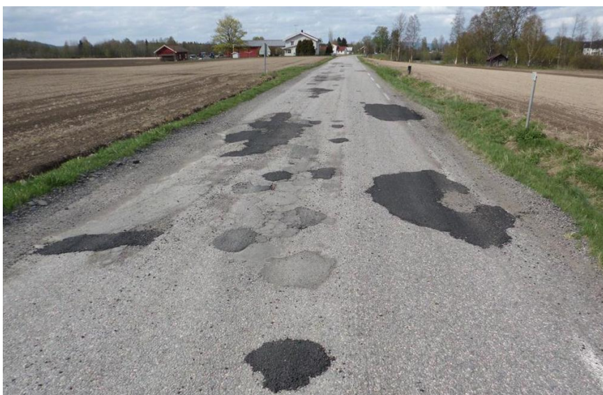
FIGUR 26 MEGET DÅRLIG DEKKETILSTAND PÅ FV 283 I SØR-ODAL KOMMUNE (FOTO: STATENS VEGVESEN)
