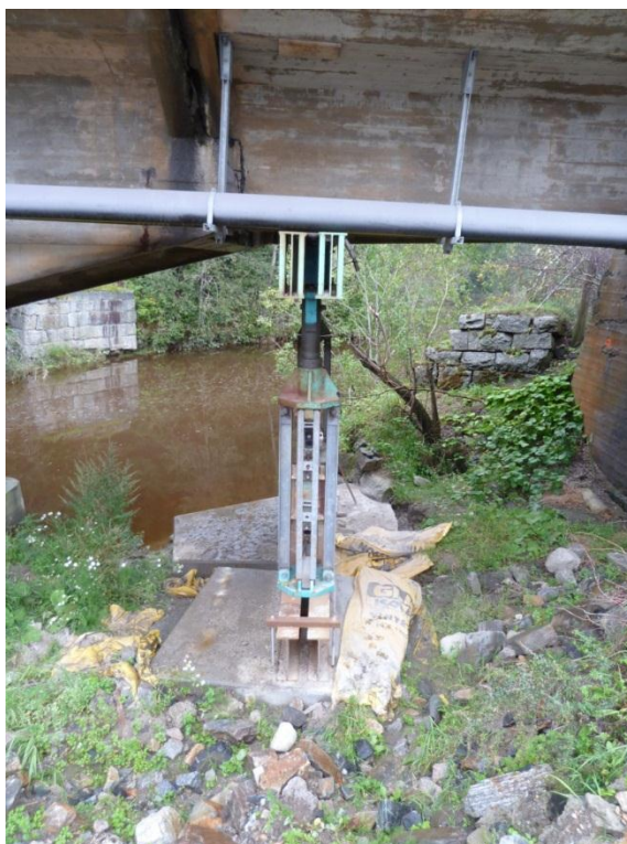
FIGUR 22 SKJELLFOSS BRU PÅ FV 120 – UNDERSTØTTELSE GRUNNET SKADE (FOTO: STATENS VEGVESEN)
