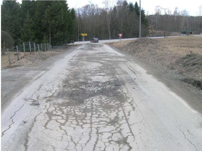
FIGUR 9 EKSEMPEL PÅ VEGDEKKE I FULLSTENDIG OPPLØSNING GRUNNET SVAKT VEGFUNDAMENT OG MANGLENDE DRENERING (FOTO: STATENS VEGVESEN)
