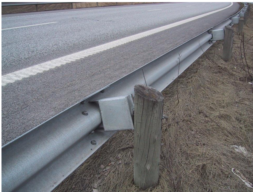
FIGUR 11 EKSEMPEL PÅ REKKVERK HVOR SKADENE HAR UTVIKLET SEG OVER TID (FOTO: STATENS VEGVESEN)
