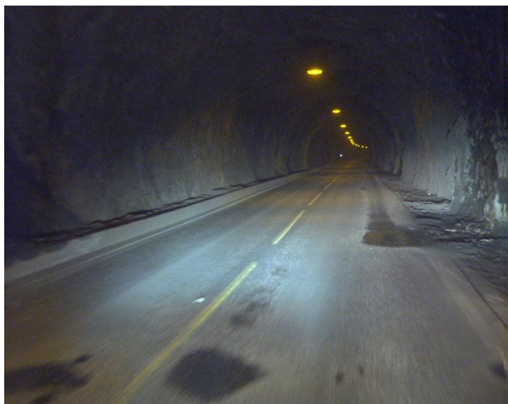
FIGUR 54 DET ER KARTLAGT STORE BEHOV FOR OPPGRADERING I HØYANGERTUNNELEN PÅ FV 55 (FOTO: STATENS VEGVESEN)
