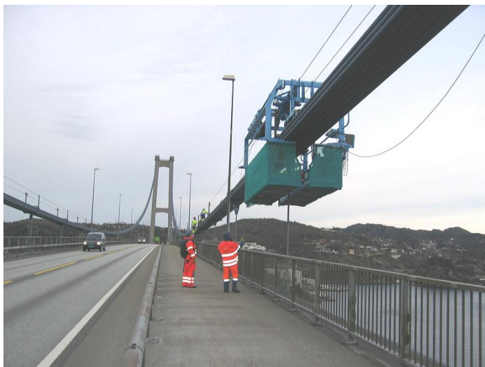
FIGUR 50 DET ER REGISTRERT BETYDELIGE KOSTNADER FOR Å FJERNE FORFALLET PÅ ASKØYBRUA PÅ FV 562 (FOTO: INGAR FASTELAND)
