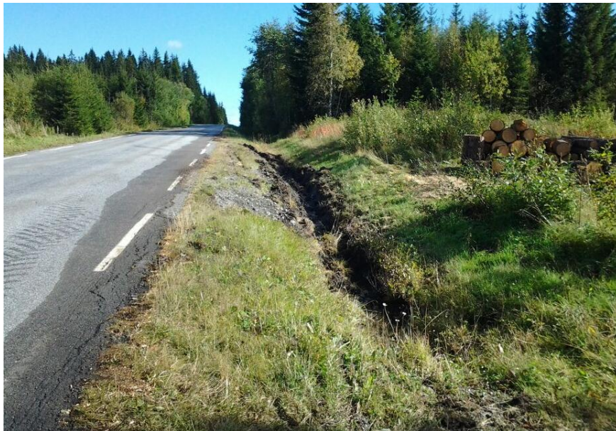
FIGUR 28 MANGELFULLT DRENSSYSTEM PÅ FV 244 I VESTRE TOTEN KOMMUNE (FOTO: STATENS VEGVESEN)
