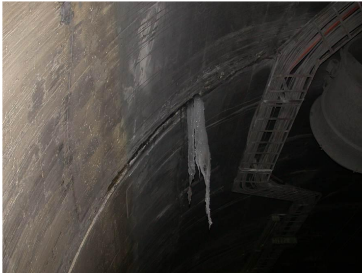
FIGUR 4 EKSEMPEL PÅ DÅRLIG VANN OG FROSTSIKRING I TUNNEL (FOTO: STATENS VEGVESEN)
