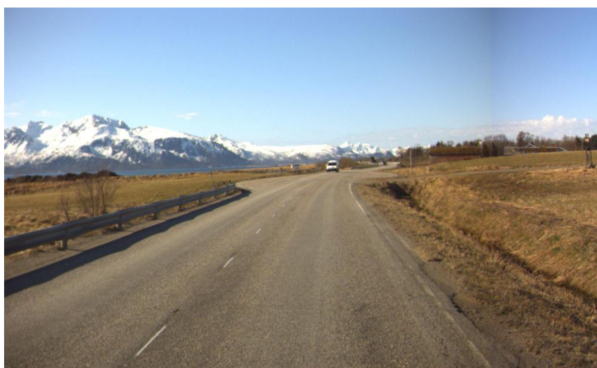
FIGUR 71 SPORETE OG SLITT VEGDEKKE PÅ FV 82 NÆR SORTLAND (FOTO: STATENS VEGVESEN)
