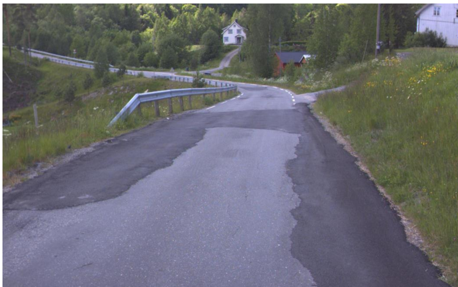
FIGUR 39 MIDLERTIDIG REPERASJON AV DEKKESKADER PÅ FV 80 I GJERSTAD KOMMUNE (FOTO: STATENS VEGVESEN)
