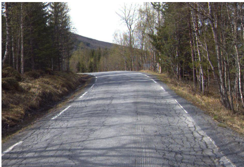
FIGUR 73 SKADER I VEGDEKKE SOM SKYLDES SVAKEHETER I VEGFUNDAMENT PÅ LAVTRAFIKKERT FV 762 I NARVIK KOMMUNE (FOTO: STATENS VEGVESEN)
