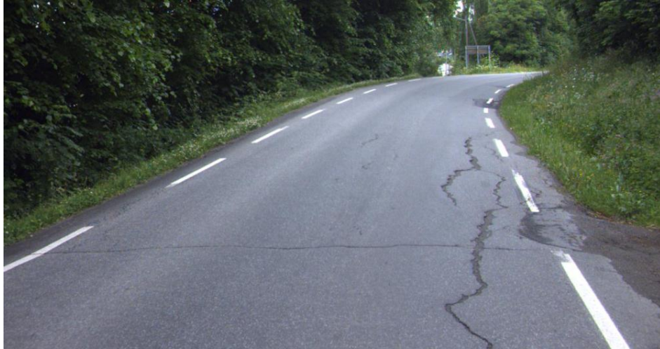
FIGUR 27 SMAL VEG MED SKADET VEGDEKKE PÅ FV 247 I SØNDRE LAND KOMMUNE (FOTO: STATENS VEGVESEN)
