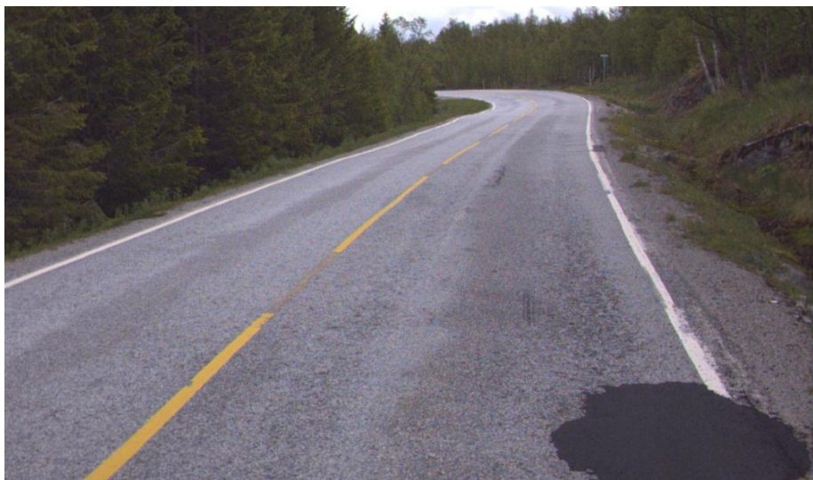
FIGUR 29 VEGDEKKE MED DYPE SPOR OG SKADER PÅ FV 40 I HOL KOMMUNE (FOTO: STATENS VEGVESEN)
