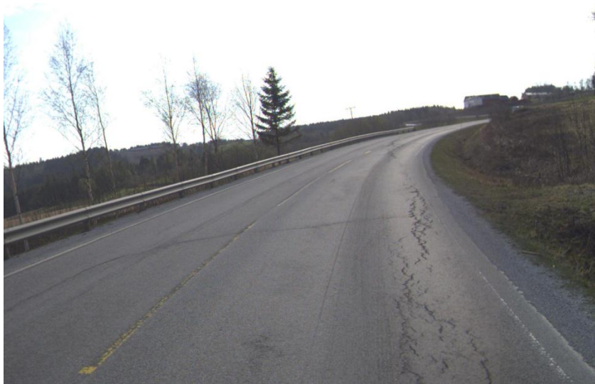
FIGUR 67 DEKKESKADER PÅ 5 ÅR GAMMELT VEGDEKKE SOM SKYLDES SVAKT VEGFUNDAMENT PÅ FV 72 I VERDAL KOMMUNE (FOTO: STATENS VEGVESEN)
