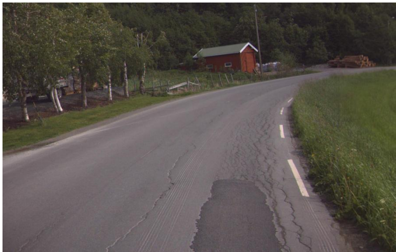
FIGUR 63 SKADER PÅ VEGDEKKE GRUNNET SVAKT VEGFUNDAMENT PÅ FV 875 I TRONDHEIM KOMMUNE (FOTO: STATENS VEGVESEN)
