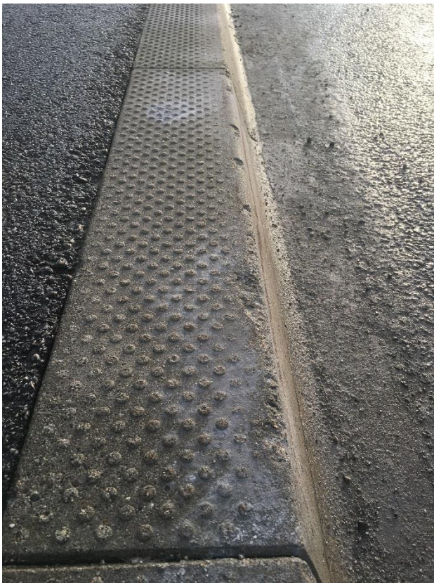
Figur 22 Eksempel skade på betongkantstein. Foto: Statens vegvesen
