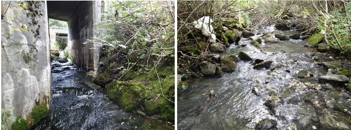
Bilder: To kulverter under Auranvegen, t.v. og bunndyrstasjonen øverst i Mæraselva, t.h.
