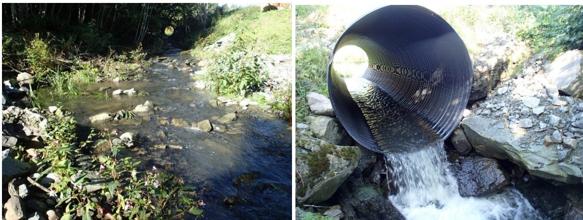
Bilder: Parti fra elfiskestasjonen i Myrelva, t.v. og kulvert øverst i Myrelva t.h.
