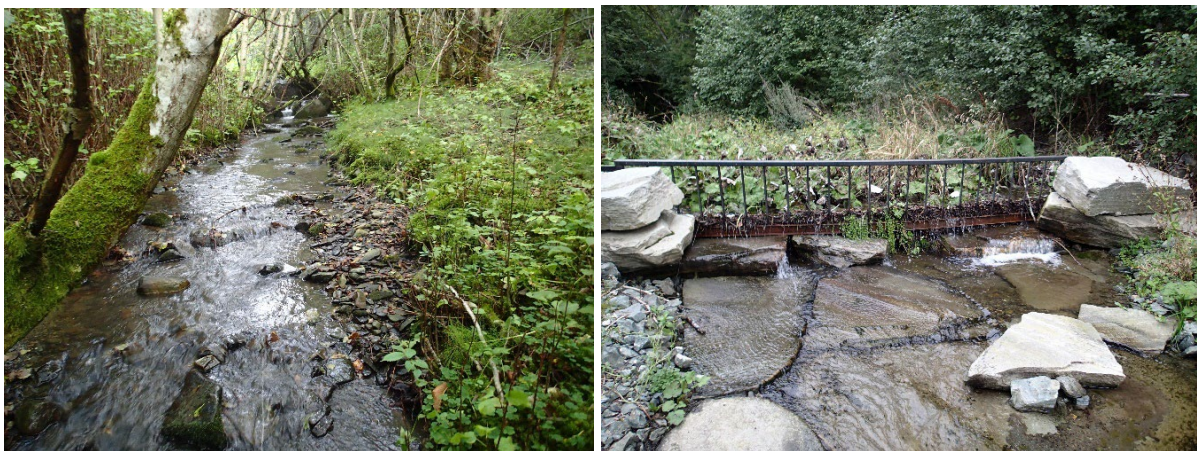
Bilder: Devlabekken går gjennom en ravinedal med mye kantvegetasjon (t.v.). Et sperregitter like oppstrøms jernbanekrysninga har blitt tettet igjen og er trolig vandringshindrende for fisk (t.h).
