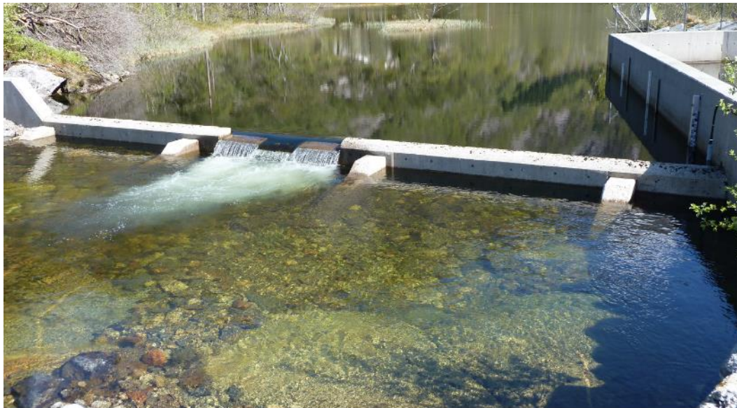
Figur 8. Bildet viser en terskel med to ulike rektangulære profil. Det laveste profilet skal dokumentere minstevannføring på 60 l/s, og det øverste profilet en minstevannføring på 600 l/s. Foto: NVE
