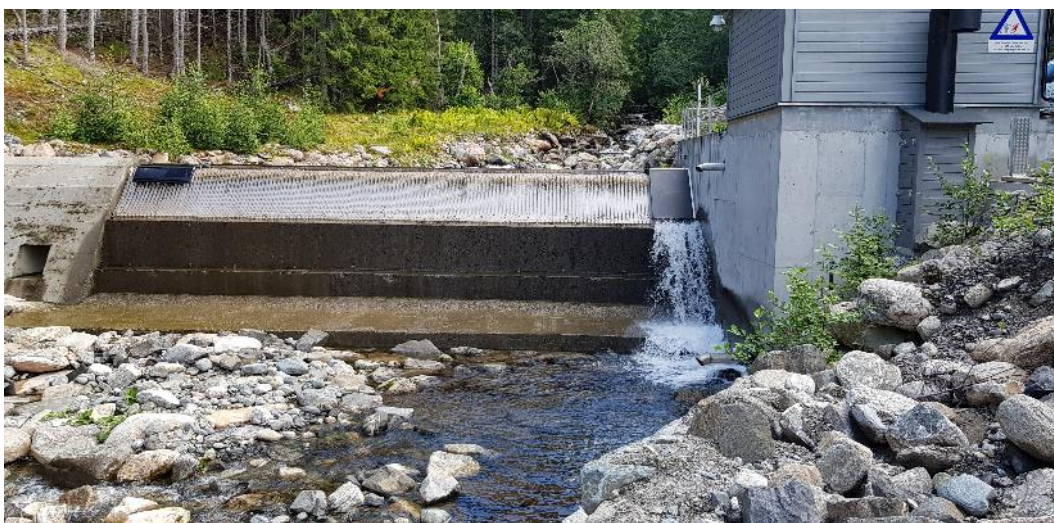
Figur 13. Bildet viser et inntak med coandarister og lukehus. Minstevannføringen på 50 l/s slippes over en blende på ristene, i høyre del av coandaterskelen. Metoden er under testing. Foto: Tafjord Kraft AS
