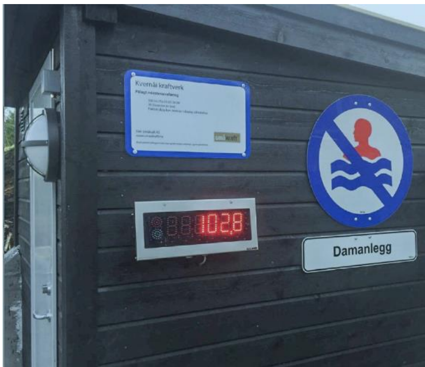
Figur 19. Ved dette inntaket er det etablert opplysningsskilt om pålagt minstevannføring og elektronisk display som viser registrert minstevannføring i nåtid. Pålagt minstevannføring er 100 l/s om sommeren og 10 l/s om vinteren. Foto: Hydrateam/Norsk Grønnkraft
