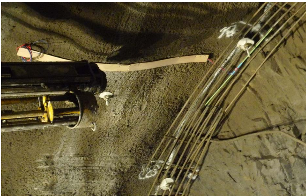
Figur 10 Utstyr for måling tøyninger langs en sikringsbue
