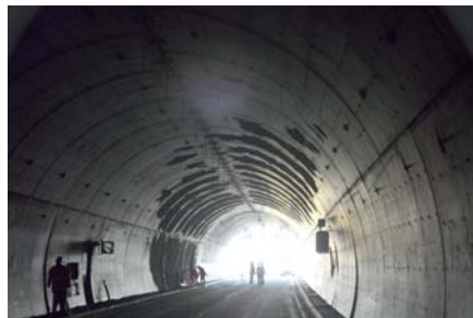
Avskallingen kan sees tydelig
