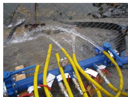
Kjølerørsystemet, enkelt og greit
