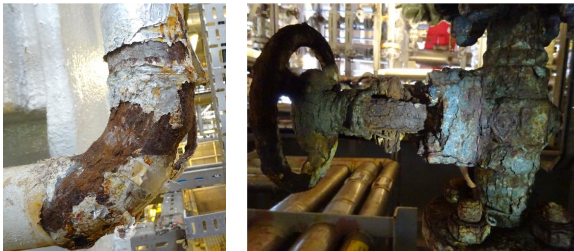
Figur 2 – Eksempler på rør og ventil utsatt for kraftig KUI, avdekket ved fjerning av isolasjon.
