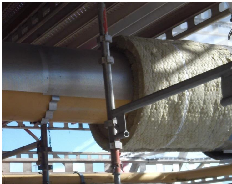
Figur 6 – Rør isolert med avstandsringer, perforert rustfri plate og mineralull.
