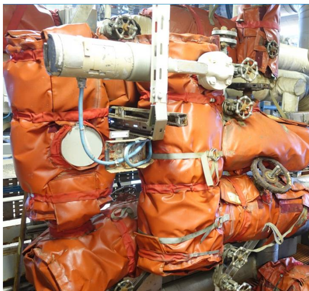
Figur 11 – Ventiler brannisolert med puter.
