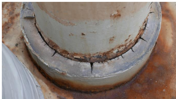
Figur 17 – Eksempel på korrosjon i dekksgjennomføring.
