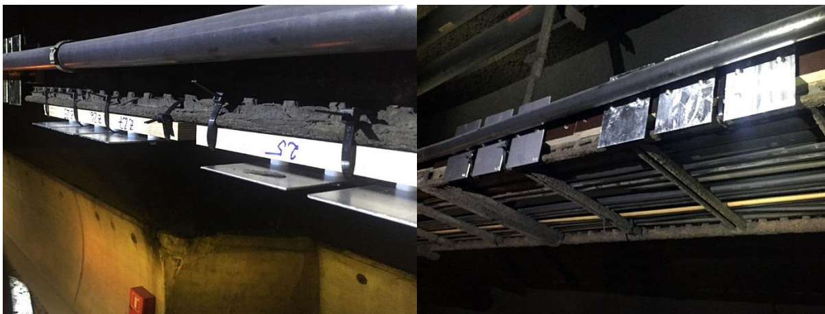
Figur 3. Prøveplater hengt opp i kabelstigen ca. midt i Ekeberg tunnelen (Prøveplater nær portal er montert på tilsvarende måte)
