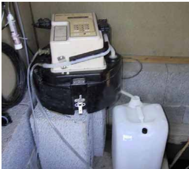
Figur 5. Målestasjon med prøvetakingsutstyr ved utløpet. Dataloggeren registrerer vannmengde. En pumpe suger prøvevann fra utløpskummen til samledunken.
