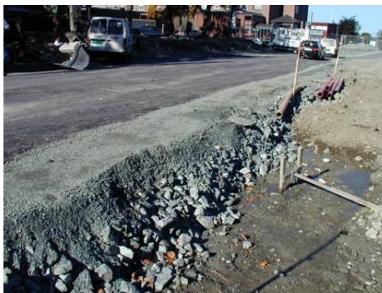
Figur 16: Gjenbruksbetong som forsterkningslag og bærelag i Harald Hardrådes gt, St Olavs Hospital
