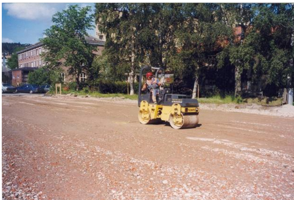
Figur 13: Knust betong og tegl som bærelag på P-plass, St Olavs Hospital
