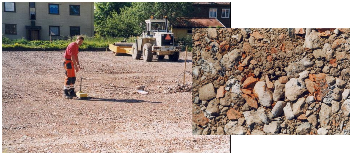
Figur 2: Betong/tegl-blanding er ømfintlig for nedknusing og har svært høyt optimalt vanninnhold pga porøsiteten (St Olavs Hospital, P-plass)
