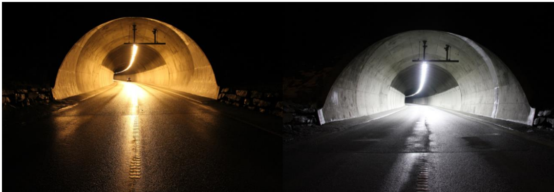
Figur 6 Gammel og ny dagsoneinstallasjon i Brekk tunnelen (bilde tatt nattetid)
