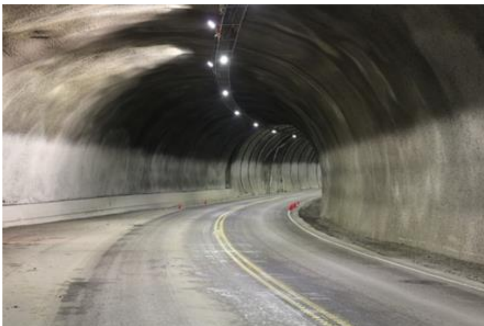
Figur 3 Presturatunnelen med LED-belysning i indre sone
