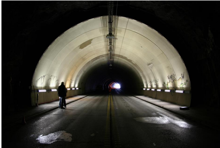
Figur 17 Eksempel på opplyste vegger og tak i innkjøringssonen
