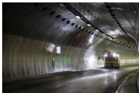
Mesta fra Møre og Romsdal spyler her en blanding av såpe og vann på tunnelveggen i Strindheimtunnelen i Trondheim. (Foto: Ellinor Hansen)
