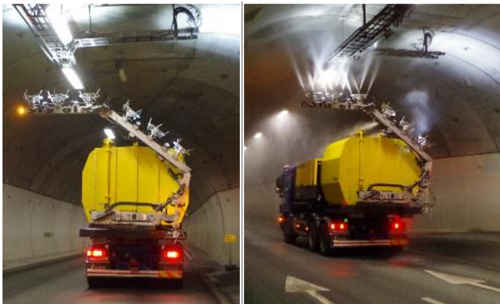
Figur 19: VeimAS sin vaskebil som brukes for hele tunnelhvelvet; vaskearmen kan beveges for å spyle armatur, tak og vegger (foto: Brynhild Snilsberg)
