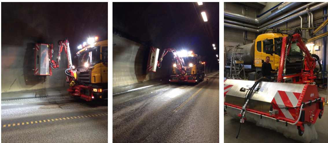
Figur 16: Tunnellvasker 2 rengjorde veggene (foto: Mesta Trondheim)
