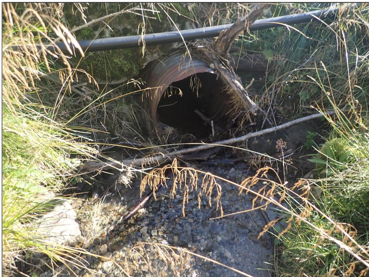
Figur 7.2. Øvre del av rør mellom segment 8 og 9, bildet viser litt oppsamling av drivved og kvister, det har i tillegg samlet seg opp drivved og kvist inne i røret.
