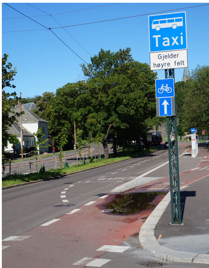
Figur 33. Bildet viser hva som skjer når man ikke tenker på overvannshåndtering. Vann samler seg i systemskiftet. Foto: Tonje Lysø, Kirkeveien ved Ullevål sykehus i Oslo.
