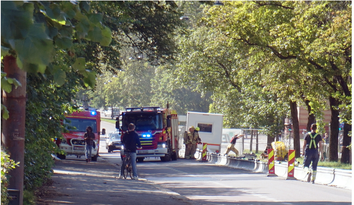
Figur 11. Bildet viser en situasjon med utrykningskjøretøy som oppstod 15. juli ved holdeplassen Fayeres gate retning øst. Det oppstod utfordringer i forbindelse med anleggsarbeidet, og på et tidspunkt var det fem utrykningskjøretøy på plassen. Foto: Tonje Lysø, Kirkeveien i Oslo.
