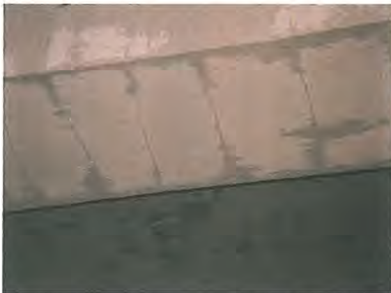
Foto 6.1 Typiske riss i underkant og nedre del av hovedbjelken med prøvestykket
