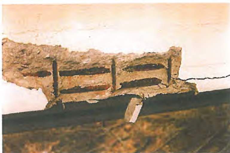
Foto 4.1 Typisk skade i underkant hovedbjelke
