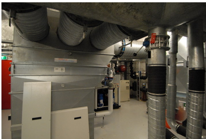
Fra ventilasjonsrommet. Foto: Leif Anker.
