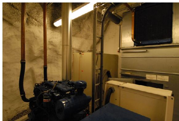
Aggregatrommet ved vestibyen. Foto: Leif Anker.
