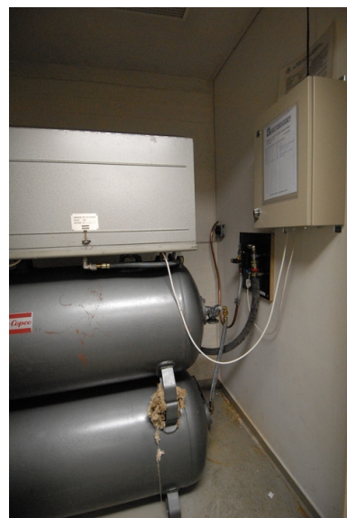
Kompressorrom. Foto: Leif Anker, Forsvarsbygg.
