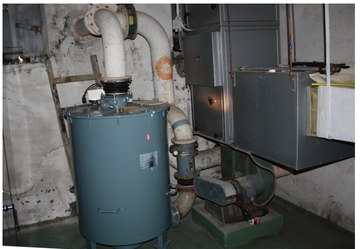
Ventilasjonsrom. Foto: Tore Pettersen, DSB.
