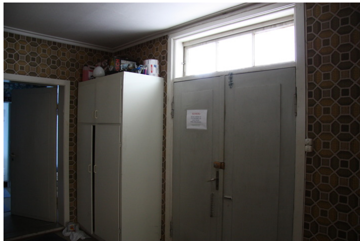
Hovedinngangen fra gaten fremstår i dag langt fra opprinnelig funksjon som inngang til en "alvorlig" samfunnsinstitusjon. Opphavsrett: Statsbygg.
