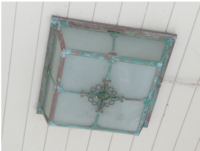
Lampe i taket over verandaen. Opphavsrett: Statsbygg.
