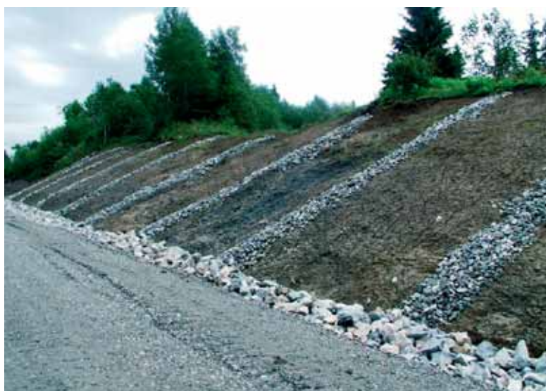
Figur 245.6 Skråningsdren vinkelrett på vegggrøft (Rv 120, Nannestad. Foto: Arvid Sagbakken)
