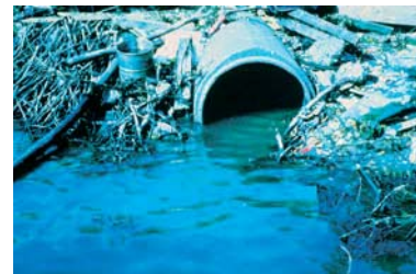
Før rant kloakken urensset ut i Drammenselva
