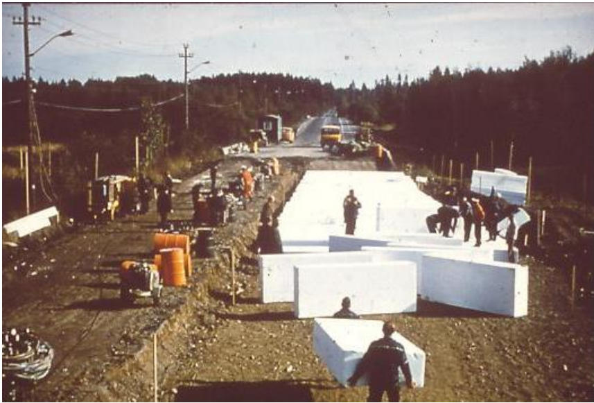
Figur 3. Det første laget av EPS-blokker er under utlegging på Flom broer (Svein Alfheim)
